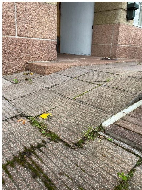
Bild 4 av ramp utanför norra entré, saknar avåkningsskydd.
