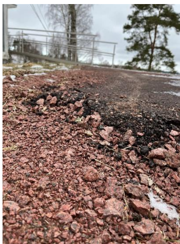
Bild 1 visar nivåskillnaden mellan gruset och den asfalterade delen vid rampen.
