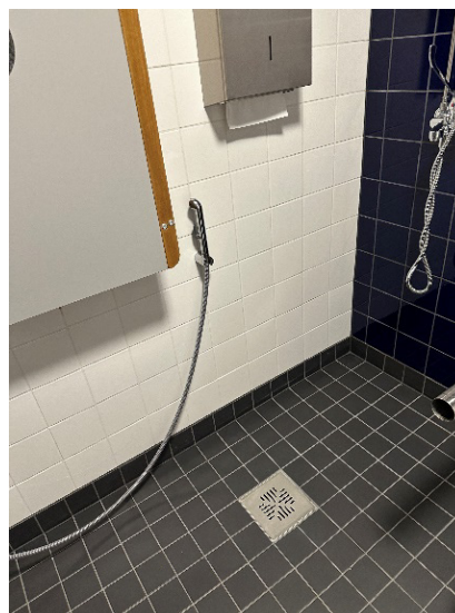
Bild 11. Handdusch vid väggen.
