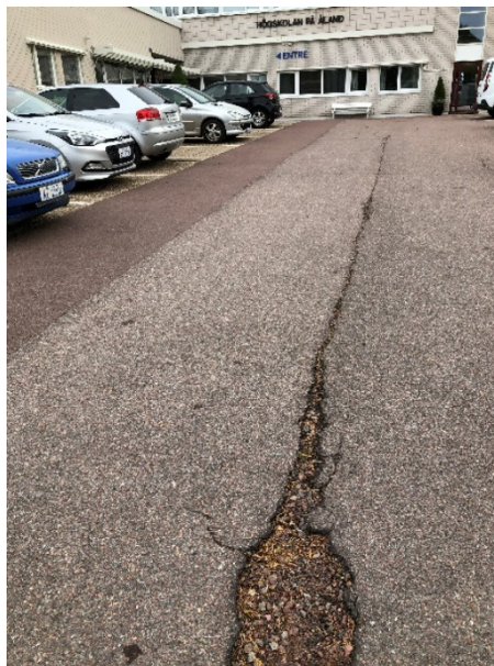
Bild 1: Håligheter i asfalten vid parkeringen.
