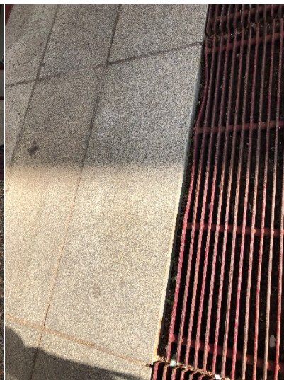
Bild 5: Ojämnheter mellan galler och stenplattor.
