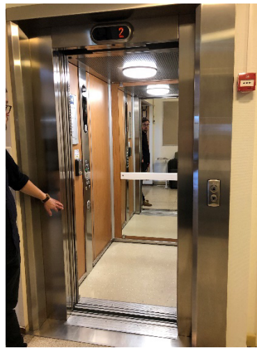
Bild 27: Spegeln är installerad för nära golvnivån.
