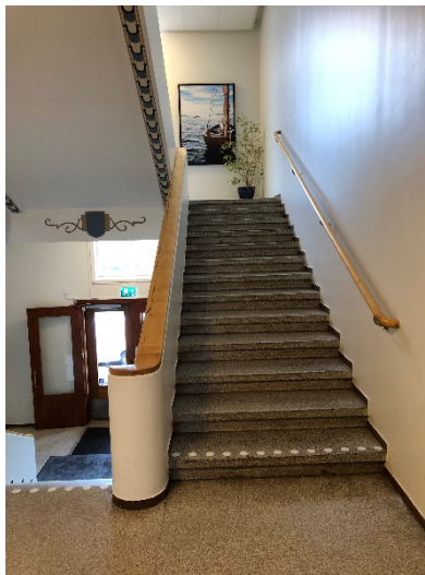
Bild 24: Ledstängerna är inte korrekt utformade.
