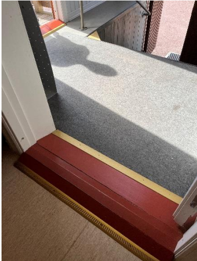
En bild av avfasade trösklar.
