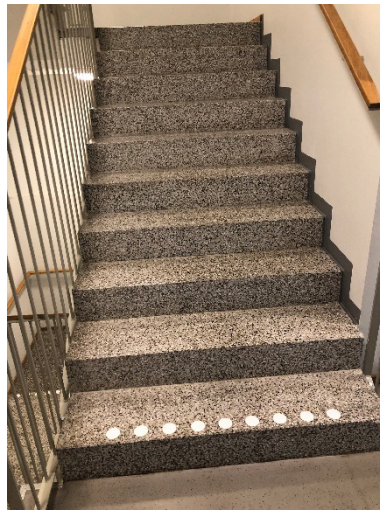
Bild 33: Det saknas kontrastmarkering av varje trappsteg på Trobergshemmet.
