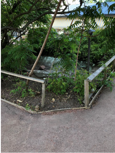
Bild 8: Det saknas delar av staketet och avåkningskydd.
