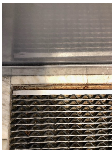
Bild 7 av glipan mellan mattan och golvet i vindfånget.
