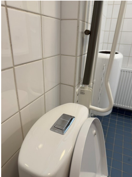
43. Toalettstolen är installerad för nära väggen.
