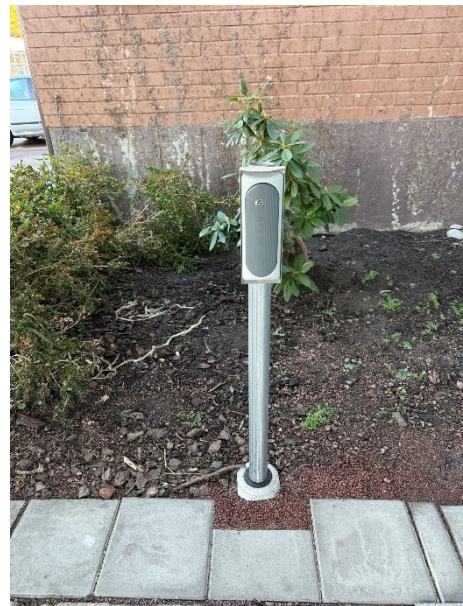
12. Den automatiska dörröppnaren.
