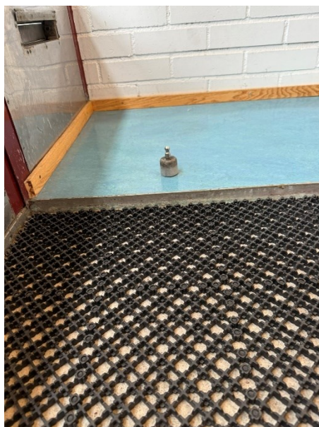
52. Vindfånget har för små dimensioner.
