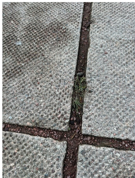
10. Glipor i markplattorna till entrén.
