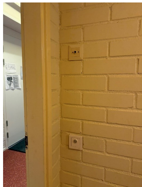
72. Det är otydligt vad som är larmknapp.
