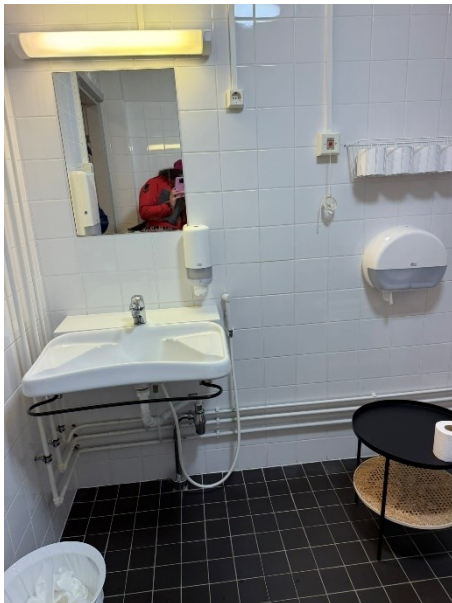
35. Larmet är inte korrekt utformat.
