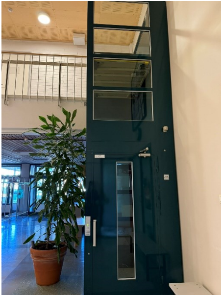
18. Plattformhissen i D-byggnaden.
