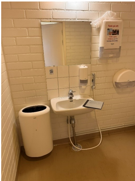
71. Spegeln är installerad på hög höjd.
