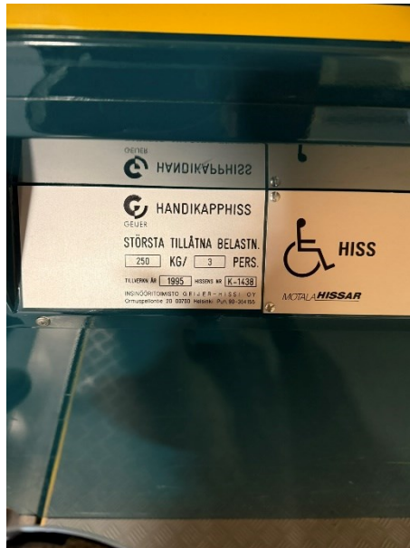
20. Utpekande skylt i plattformshissen.
