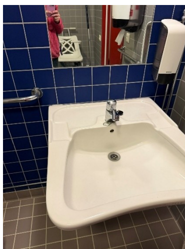
39. Handfatet är installerat för nära väggen.
