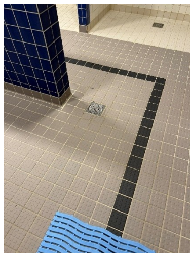
26. Vändutrymmet är för litet vid bastun och gången till simhallen.
