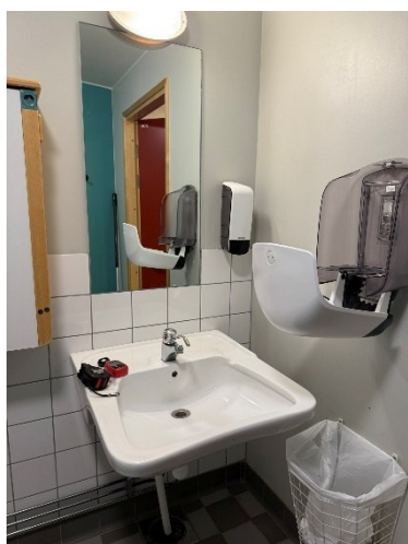
13. Kranen har en liten förlängning, en större skulle underlätta.
