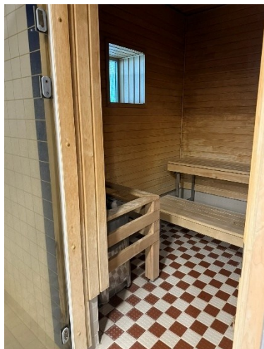
21. Staketet runt bastuaggregatet bör kontrastmarkeras.
