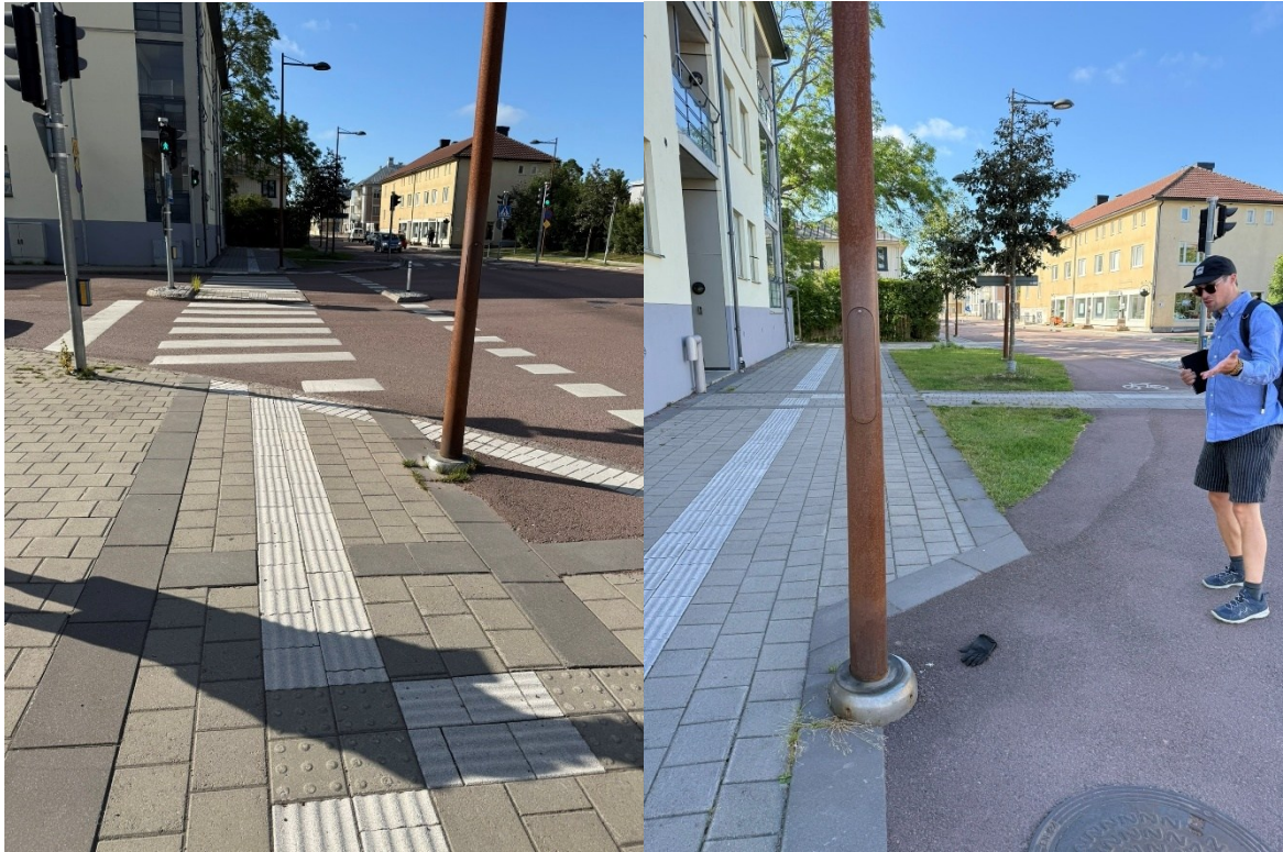
Bild 6: Varningsrelieferna är inte korrekt utformat. Bild 7: Lyktstolpar i gångstråken kan orsaka kollisionrisk.
