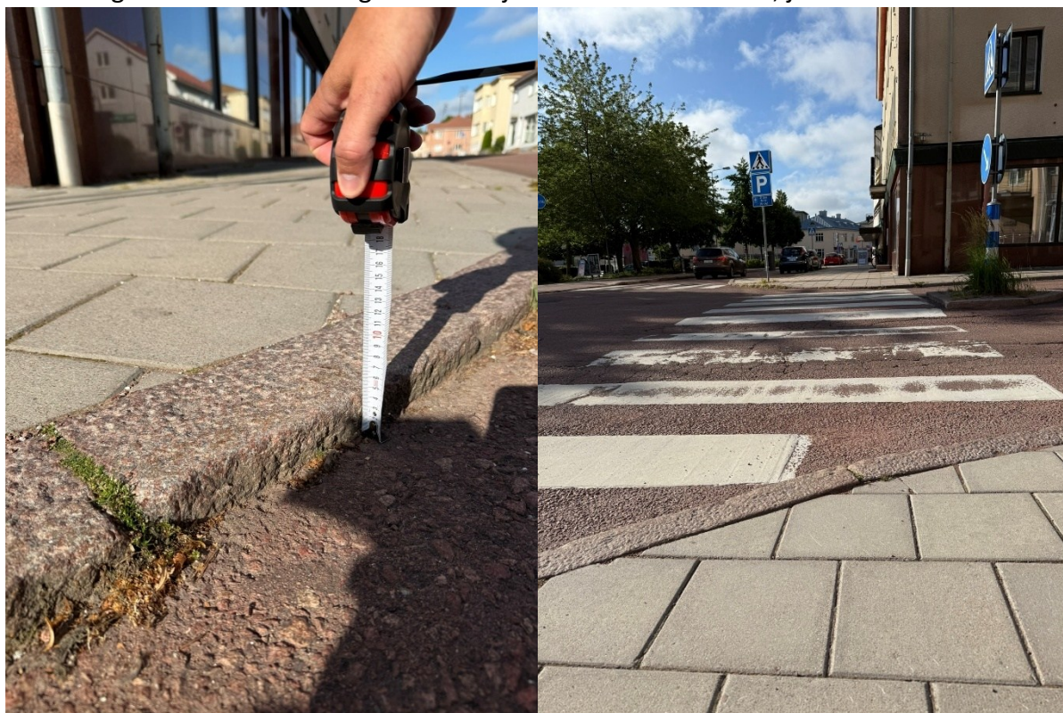
Bild 1: Kanten vid trottoaren är hög. Bild 2: Det finns håligheter i marken som kan utgöra snubbelrisk.
