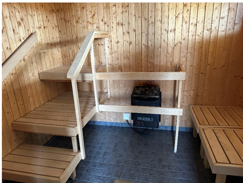
26. Det finns ett skyddande staket framför bastuaggregatet.
