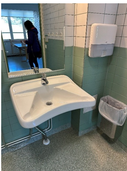
32. Handfatet är installerat för nära ett hörn.
