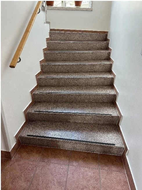
22. Ledstängerna är inte korrekt utformade.
