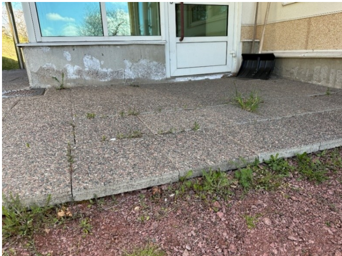
25. Nivåskillnaden bör utjämnas.
