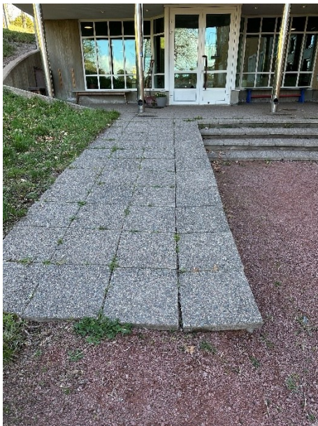
12. Rampen är farlig att använda.
