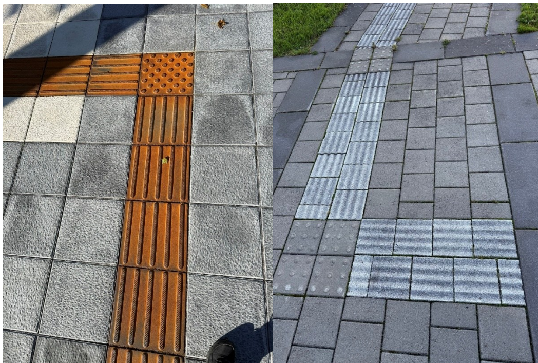
Bild 3: Varningsplattor och taktila ledstråk i Självstyrelseparken. Bild 4: Varningsplattor och taktila reliefer på Ålandsvägen.
