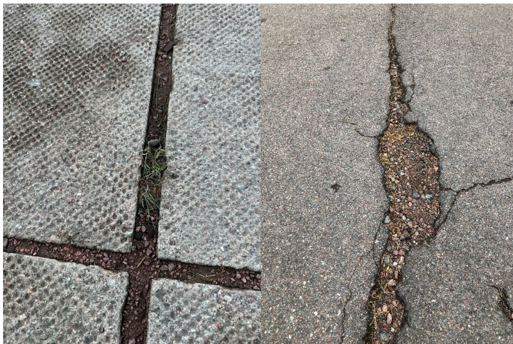
Bild 1: Stora glipor mellan markplattor vid en entré. Bild 2: Hål i en asfalterad väg som kan utgöra snubbelrisk.
