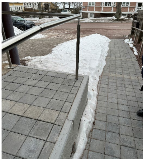
Bild 5. Rampens hörn, avåkningsskydd saknas.
