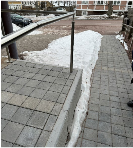
Bild 5. Rampens hörn, avåkningskydd saknas.
