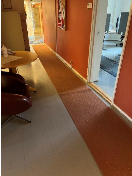
Bild på lös matta i korridor.
