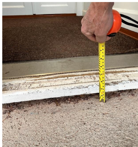
Bild av måttband visar höjden på tröskeln vid entrén.
