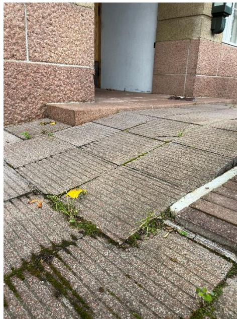
Bild 4 av ramp utanför norra entré, saknar avåkningskydd.
