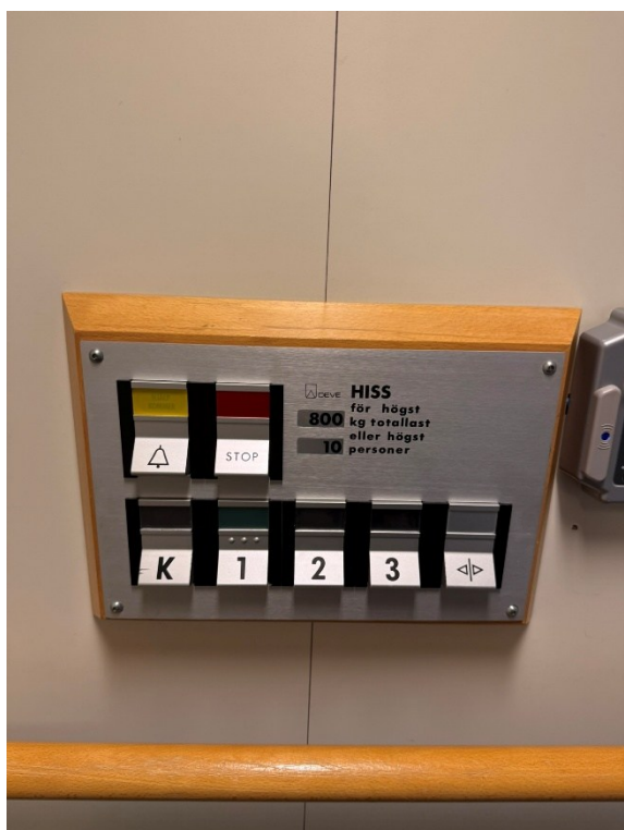
Bild 12 Kontrollpanelen i hissen.
