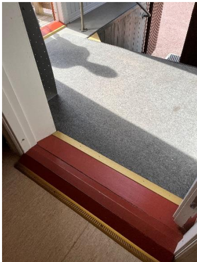
En bild av avfasade trösklar.
