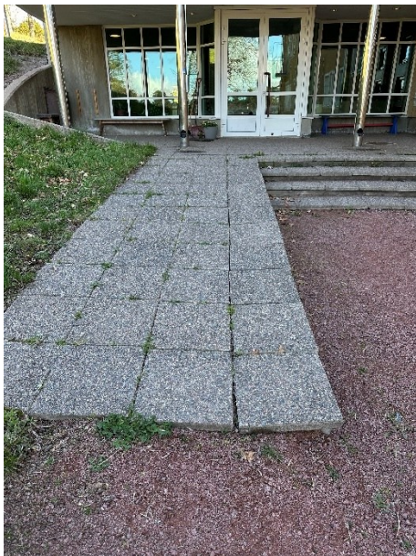
12. Rampen är farlig att använda.
