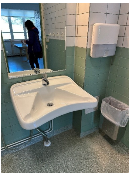
32. Handfatet är installerat för nära ett hörn.
