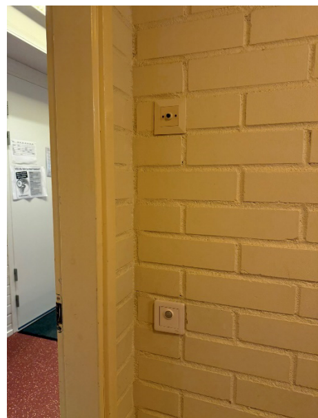
72. Det är otydligt vad som är larmknapp.
