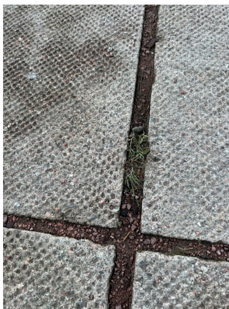
10. Glipor i markplattorna till entrén.
