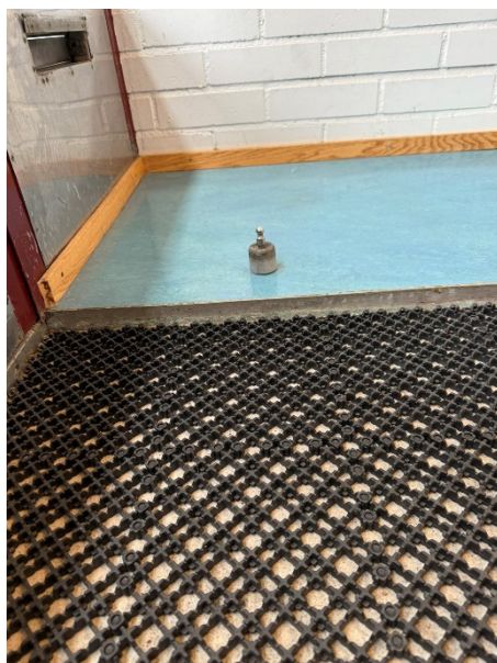
52. Vindfånget har för små dimensioner.
