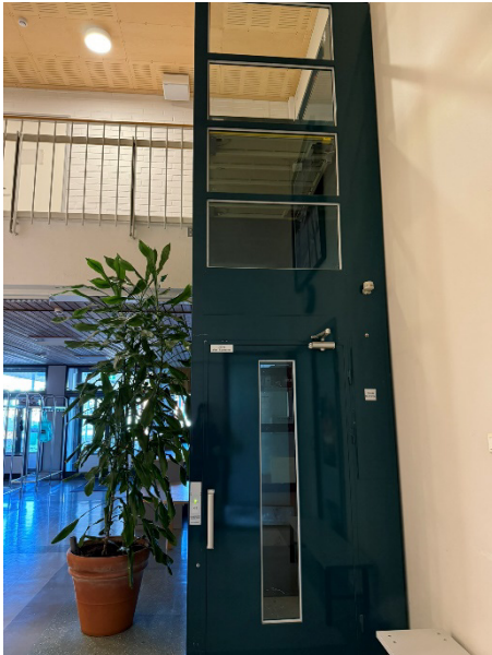
18. Plattformhissen i D-byggnaden.
