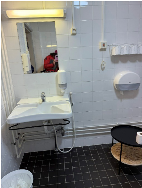
35. Larmet är inte korrekt utformat.
