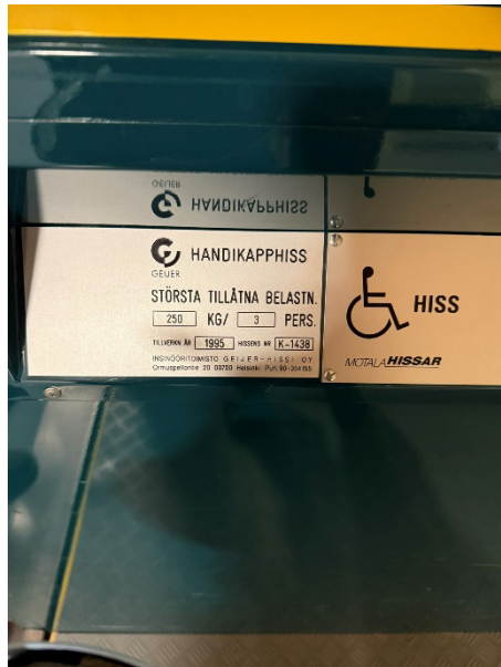
20. Utpekande skylt i plattformshissen.
