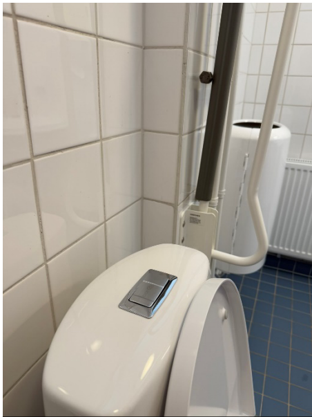
43. Toalettstolen är installerad för nära väggen.
