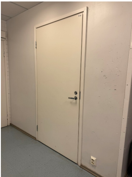
30. F-byggnadens tillgängliga toalett saknar skylt.
